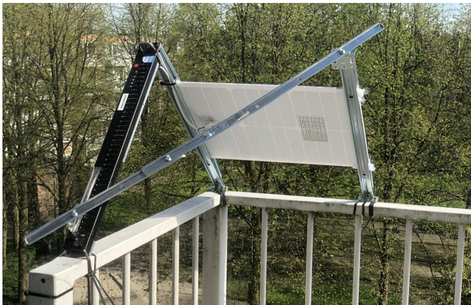
Panel solar fijado en el balcón
