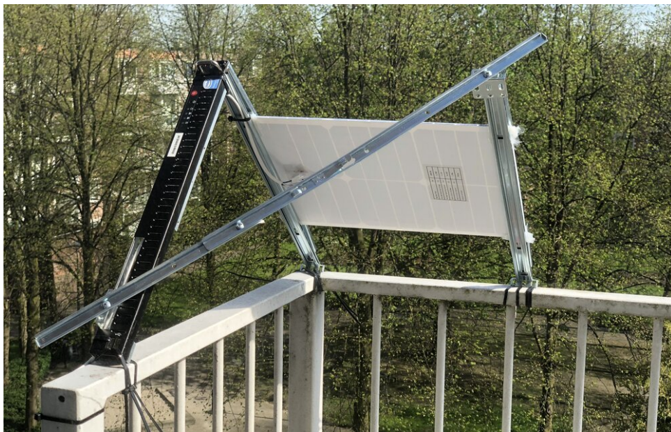
Zonnepaneel bevestigd op het balkon
