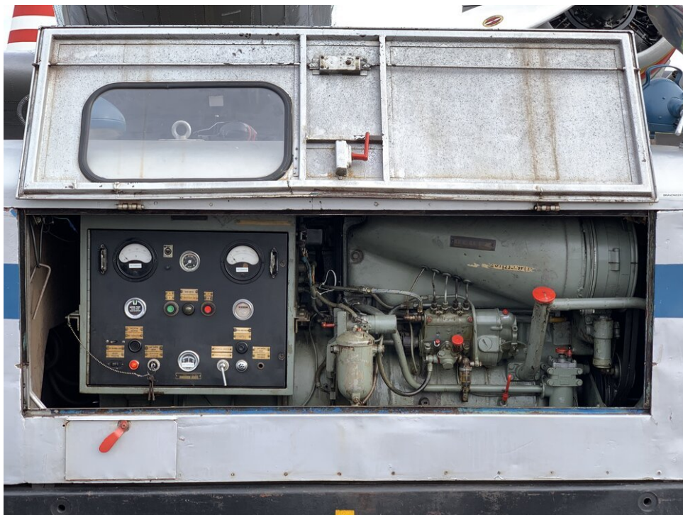
Bedieningspaneel van de elektrische generator in de platformwagen
