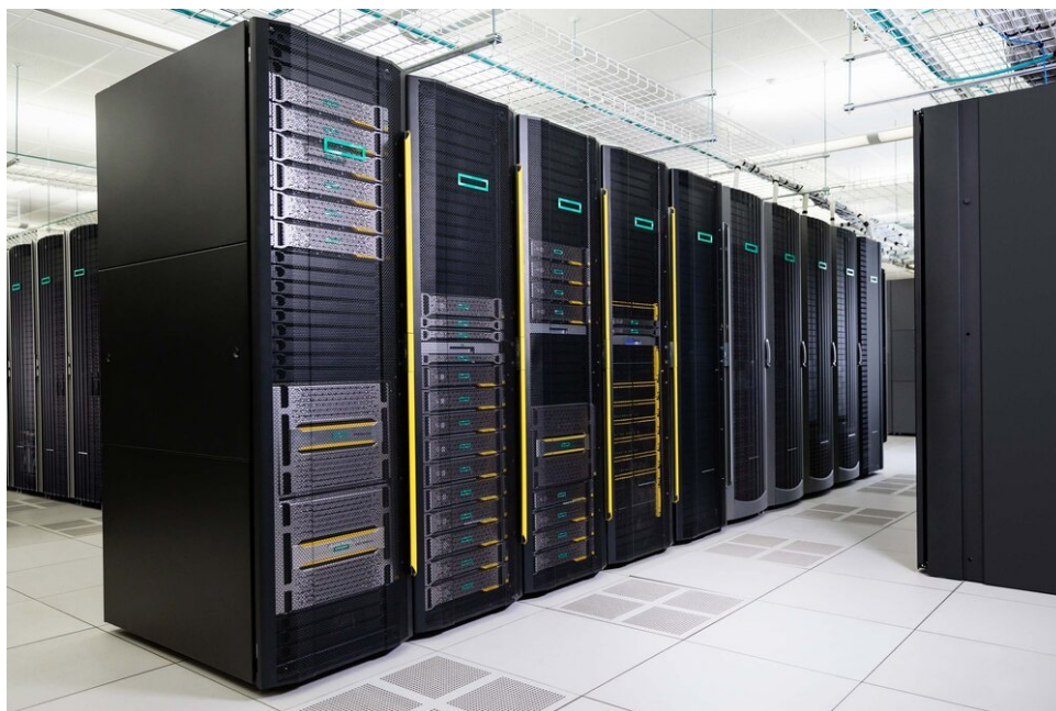
Servers in een datacenter: de zwarte racks zijn als kasten voor de grijze server computers, elke rack biedt plaats aan meerdere servers (foto: HPE).
