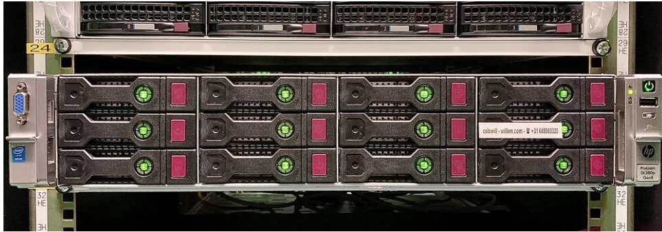
Server aangesloten en online in het datacenter
