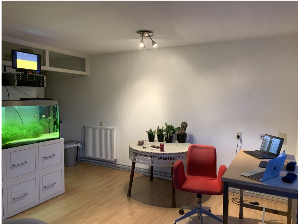
Server (linksboven) verbonden met de computers op mijn bureau (rechtsonder) tijdens de installatie in mijn kantoor
