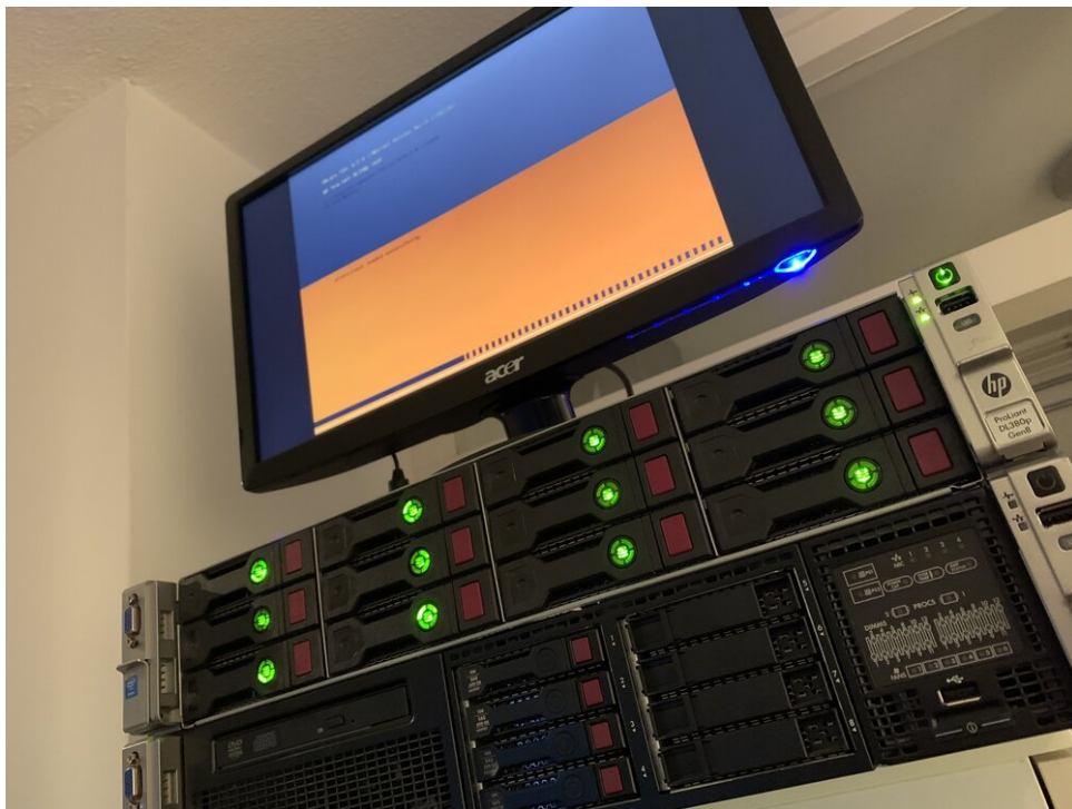
HPE ProLiant DL380p server aangezet, groene lampjes geven aan dat de schijven werken, monitor is aangesloten en toont het boot proces
